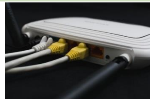
Switches, routers y antenas.
